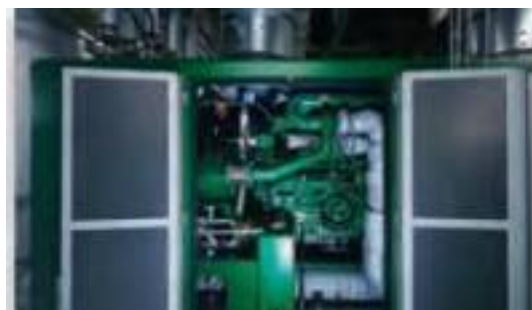
バイオガス発電機
